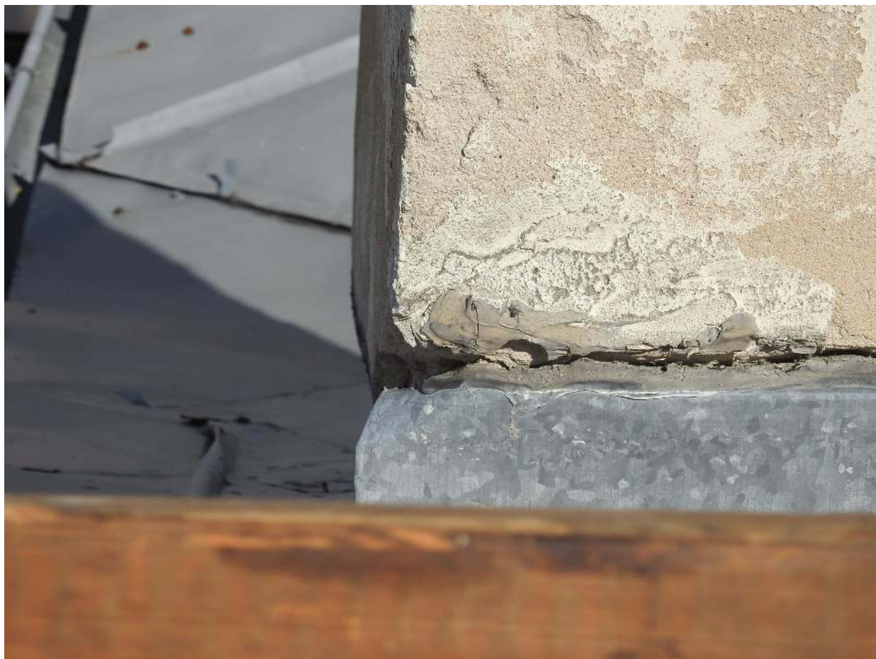
Nieprawidłowa i nieuszczelniona obróbka.
