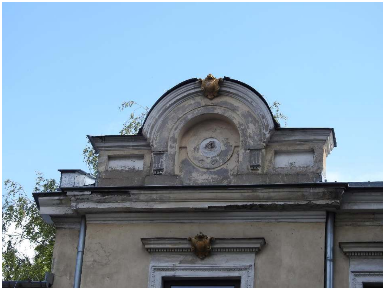
W attyce A1 erozja gzymsu świadczy o penetracji wody
