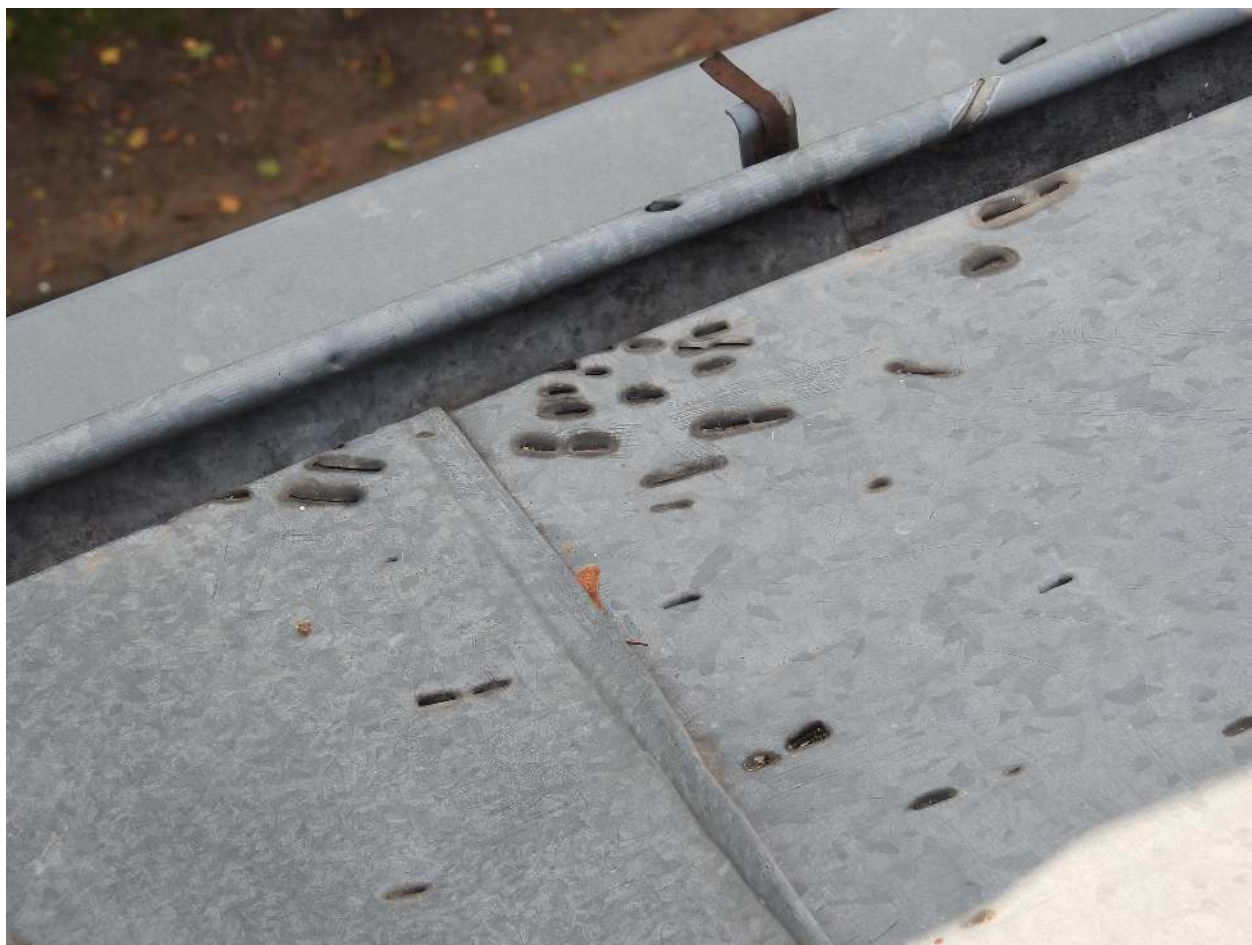
Perforacja blachy pokrycia
