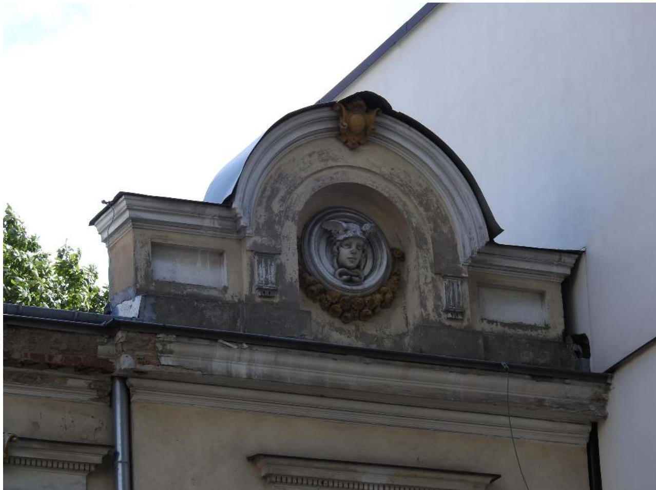
W attyce A2 erozja gzymsu świadczy o penetracji wody
