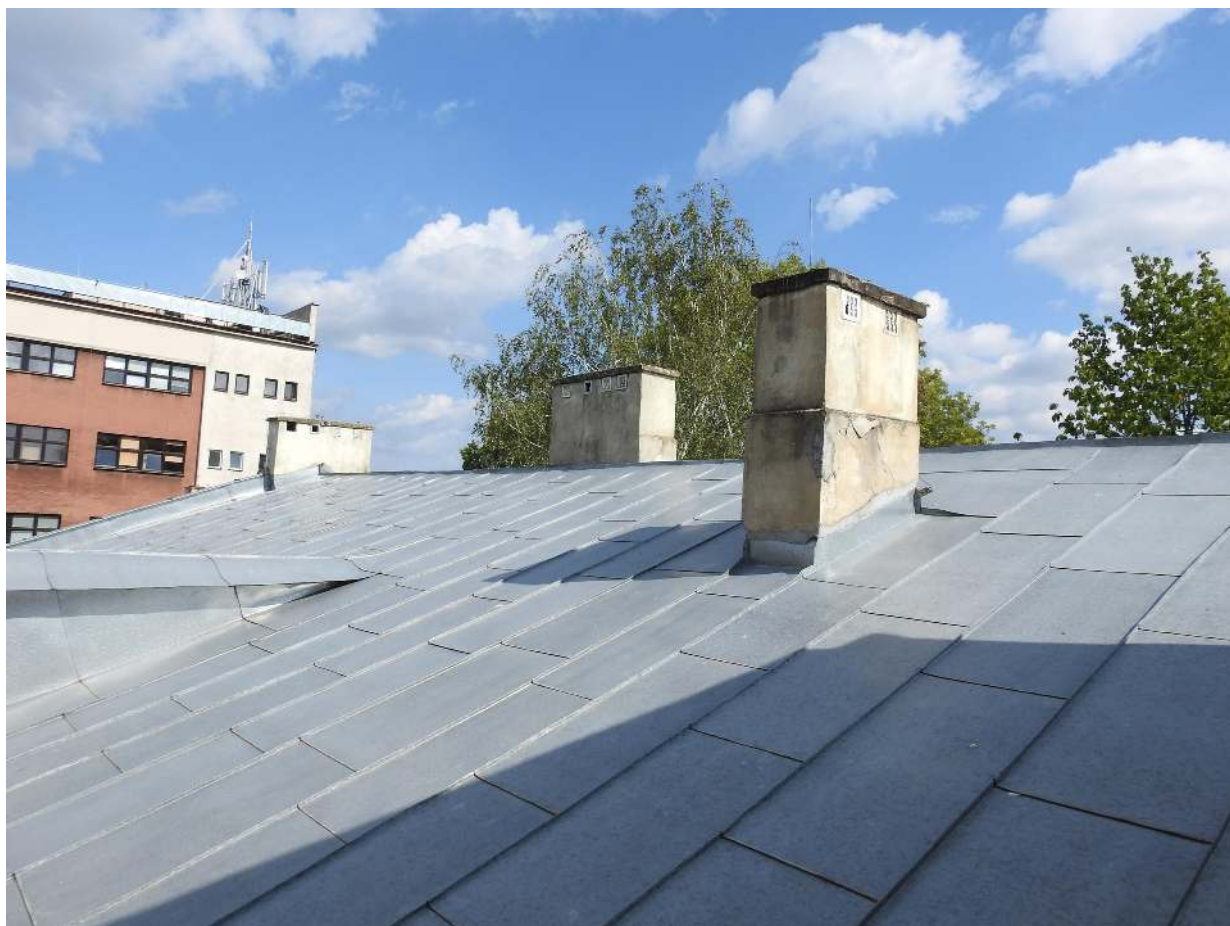
Ubytki tynku i brak obróbki czapy.
