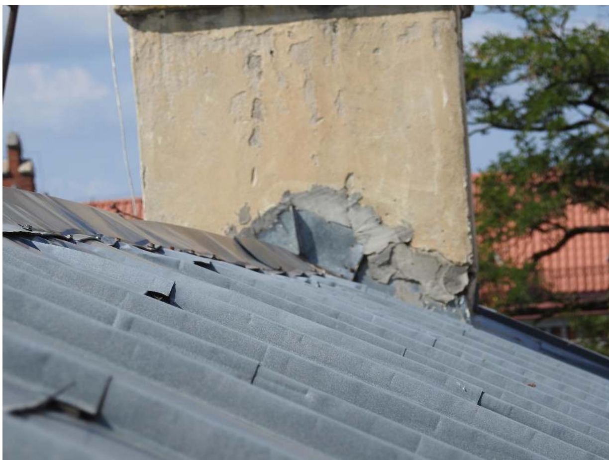
Nieprawidłowa i nieuszczelniona obróbka.
