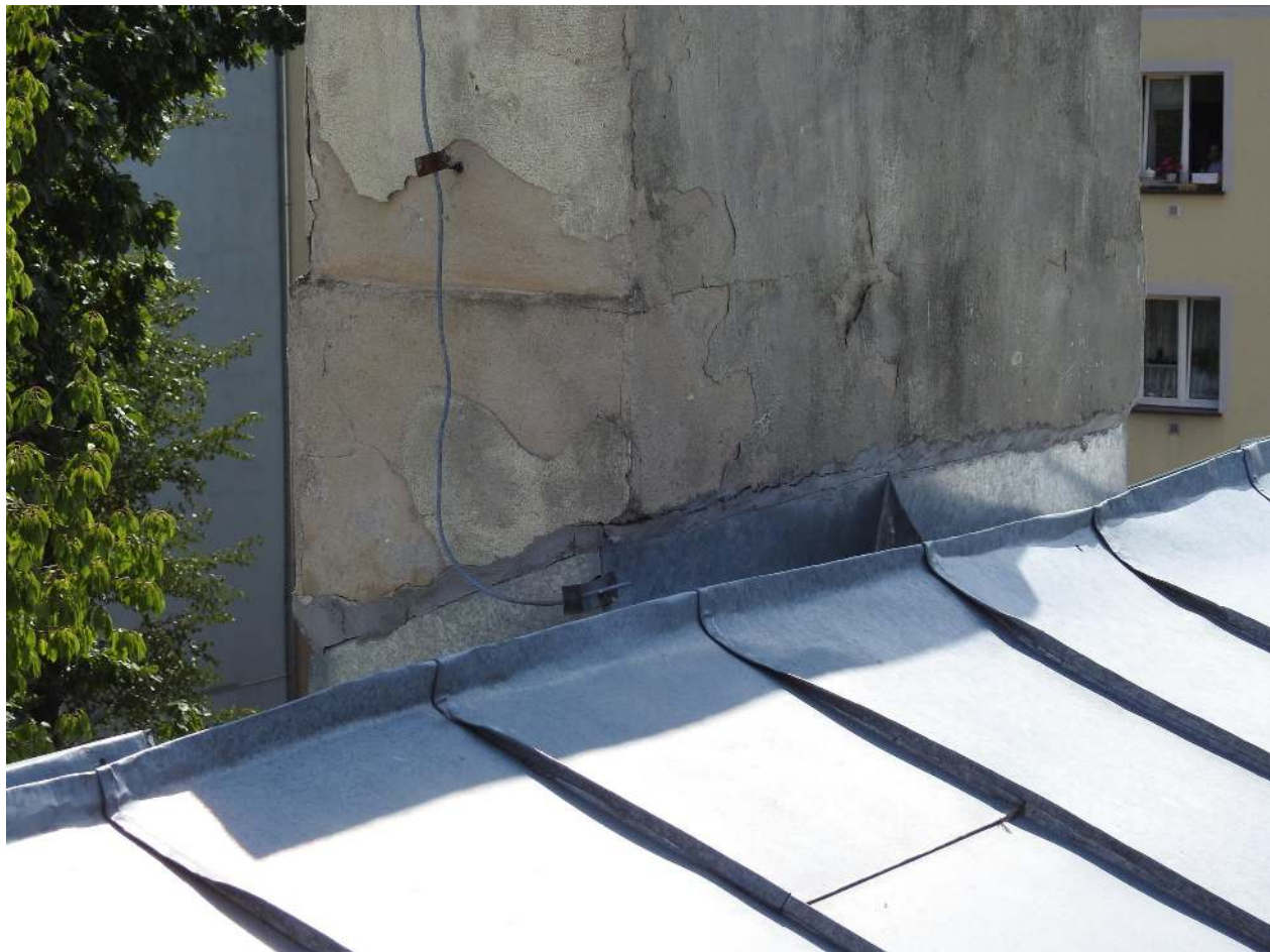
Nieprawidłowa i nieuszczelniona obróbka.
