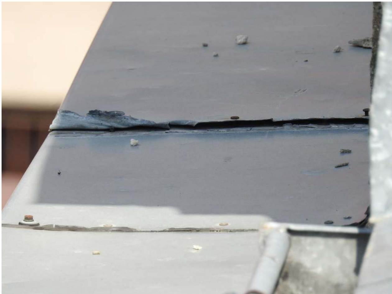
Rozwarstwiona obróbka gzymsu
