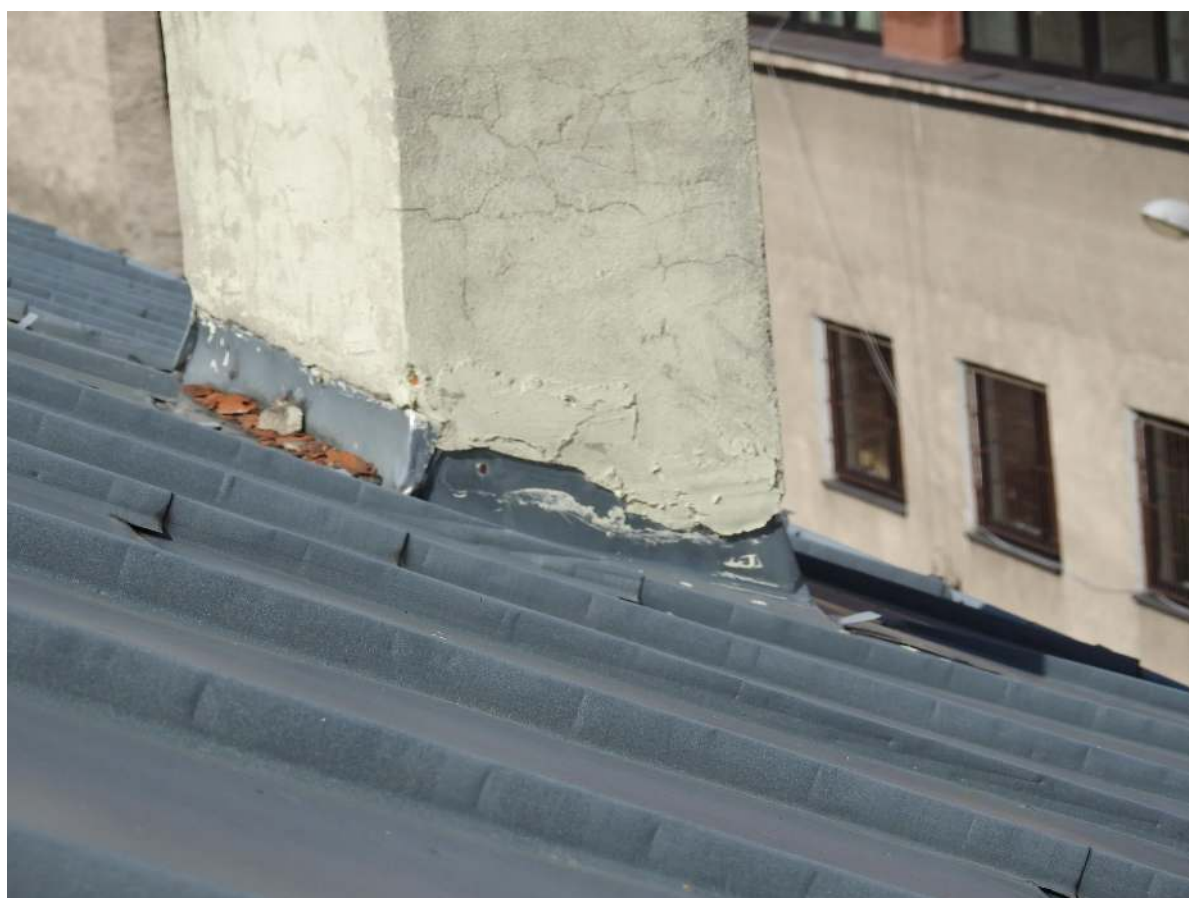
Nieprawidłowa i nieuszczelniona obróbka.
