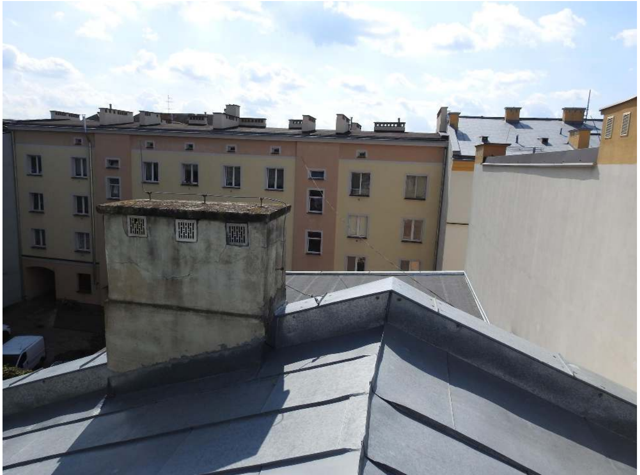
Ubytki tynku i brak obróbki czapy.
