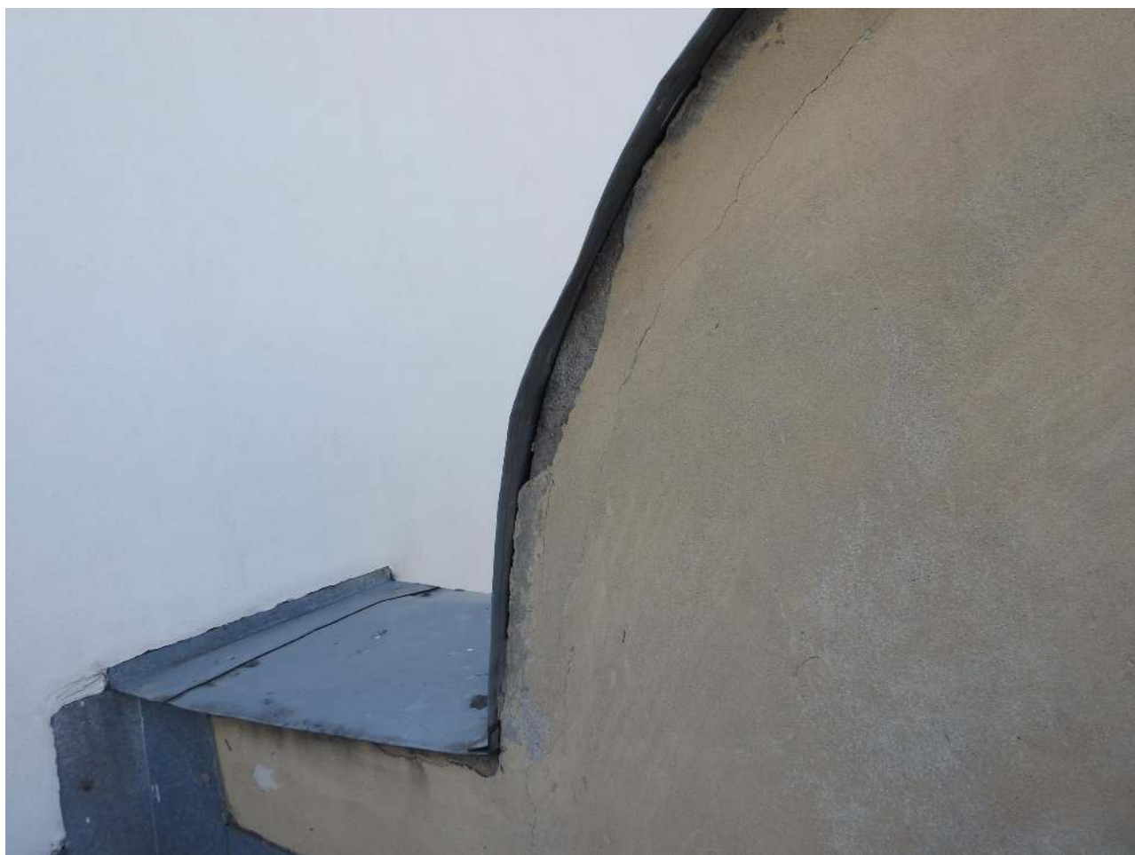
Brak kapinosów w pokryciu attyki umożliwia podciekanie wody
