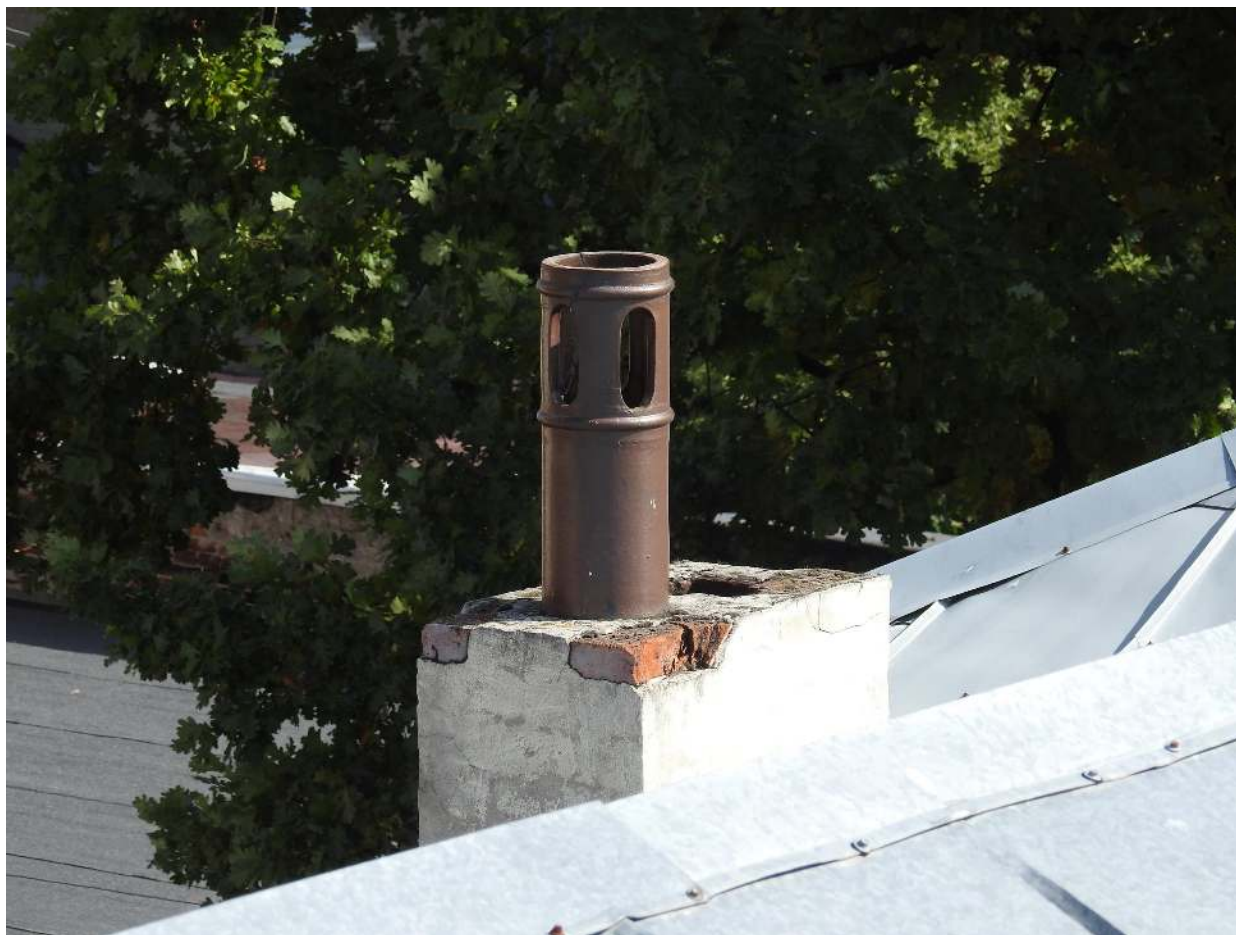
Brak czapy, odkryta wywiewka i ubytki tynku.
