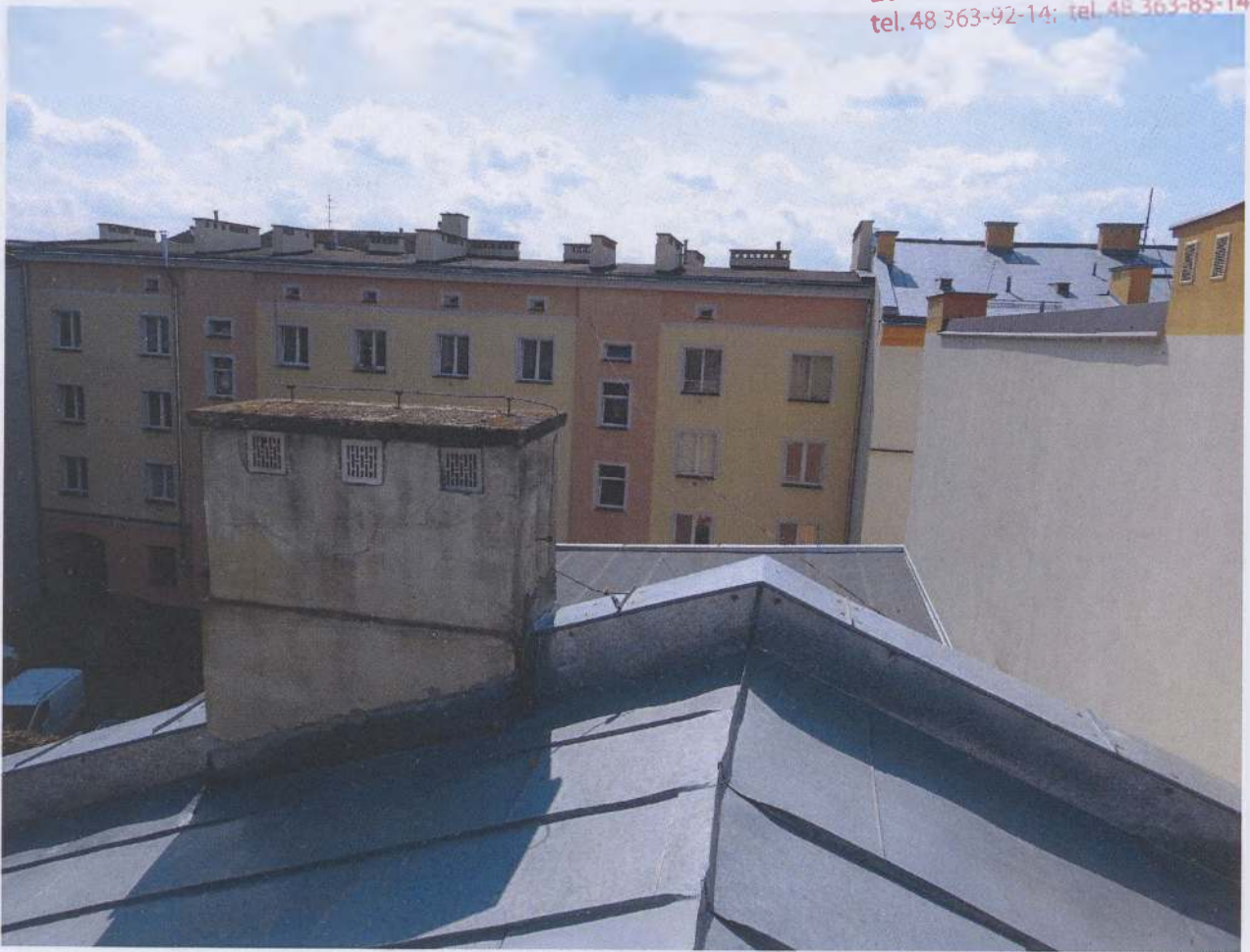
Ubytki tynku i brak obróbki czapy.
