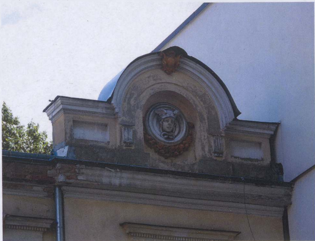
W attyce A2 erozja gzymsu świadczy o penetracji wody
