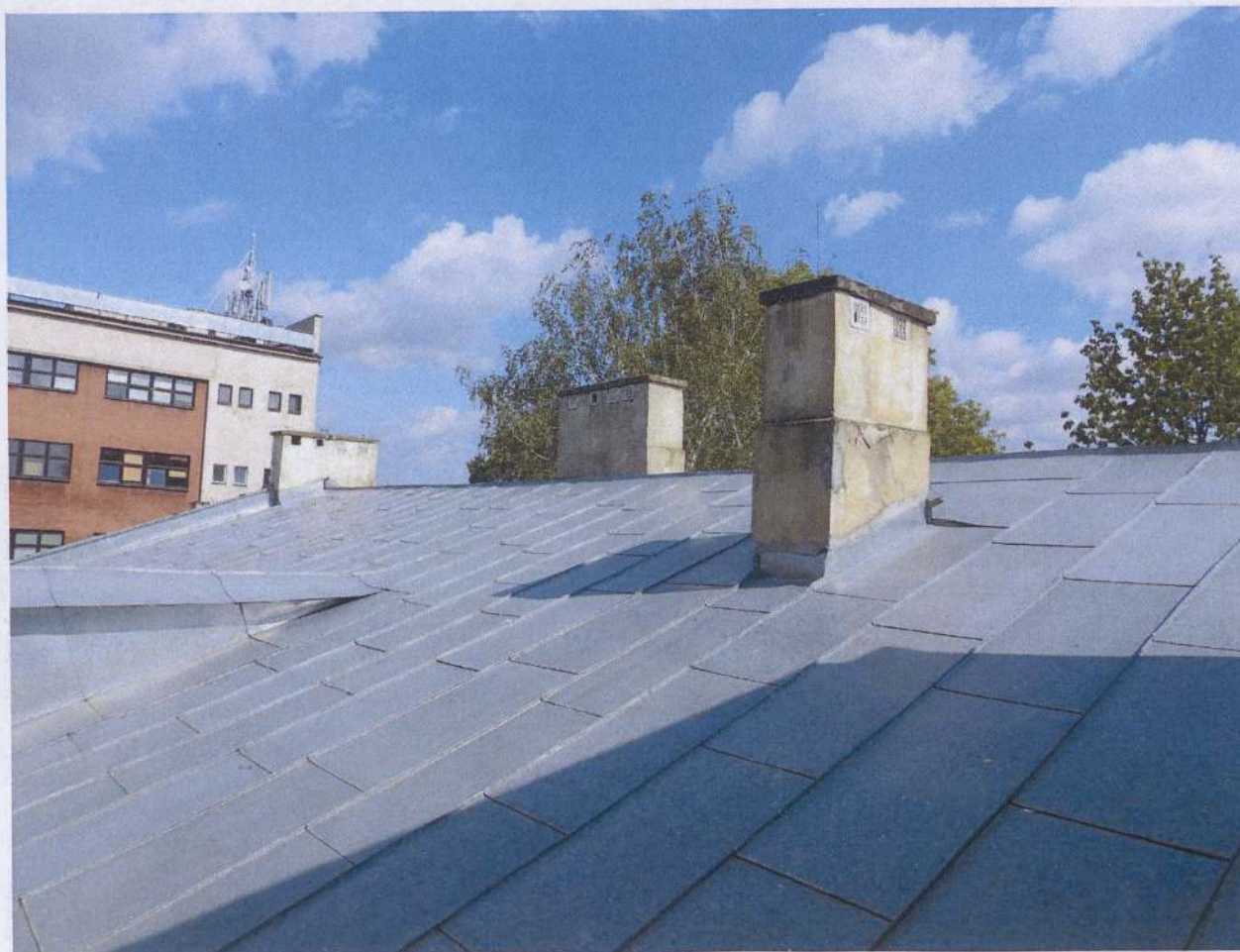
Ubytki tynku i brak obróbki czapy.
