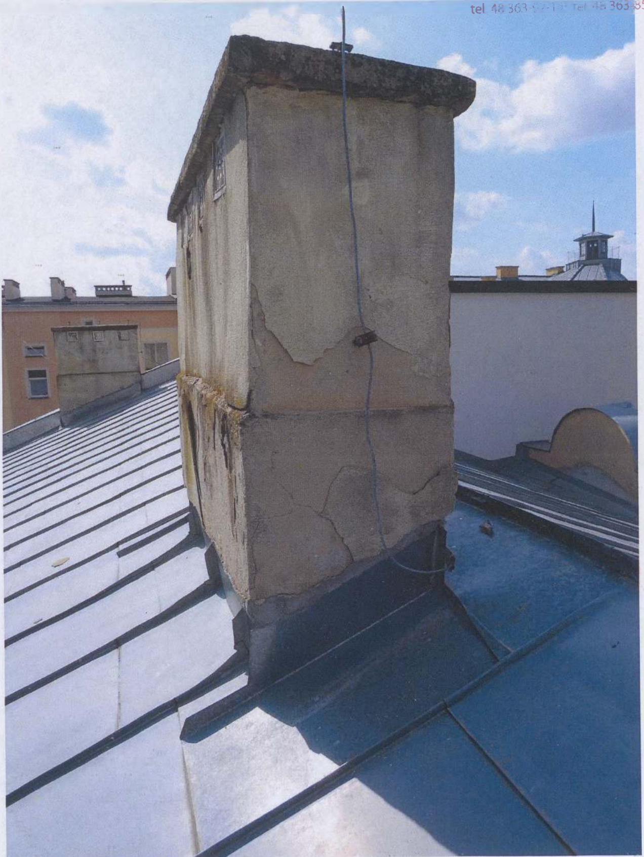
Ubytki tynku i brak obróbki czapy.
