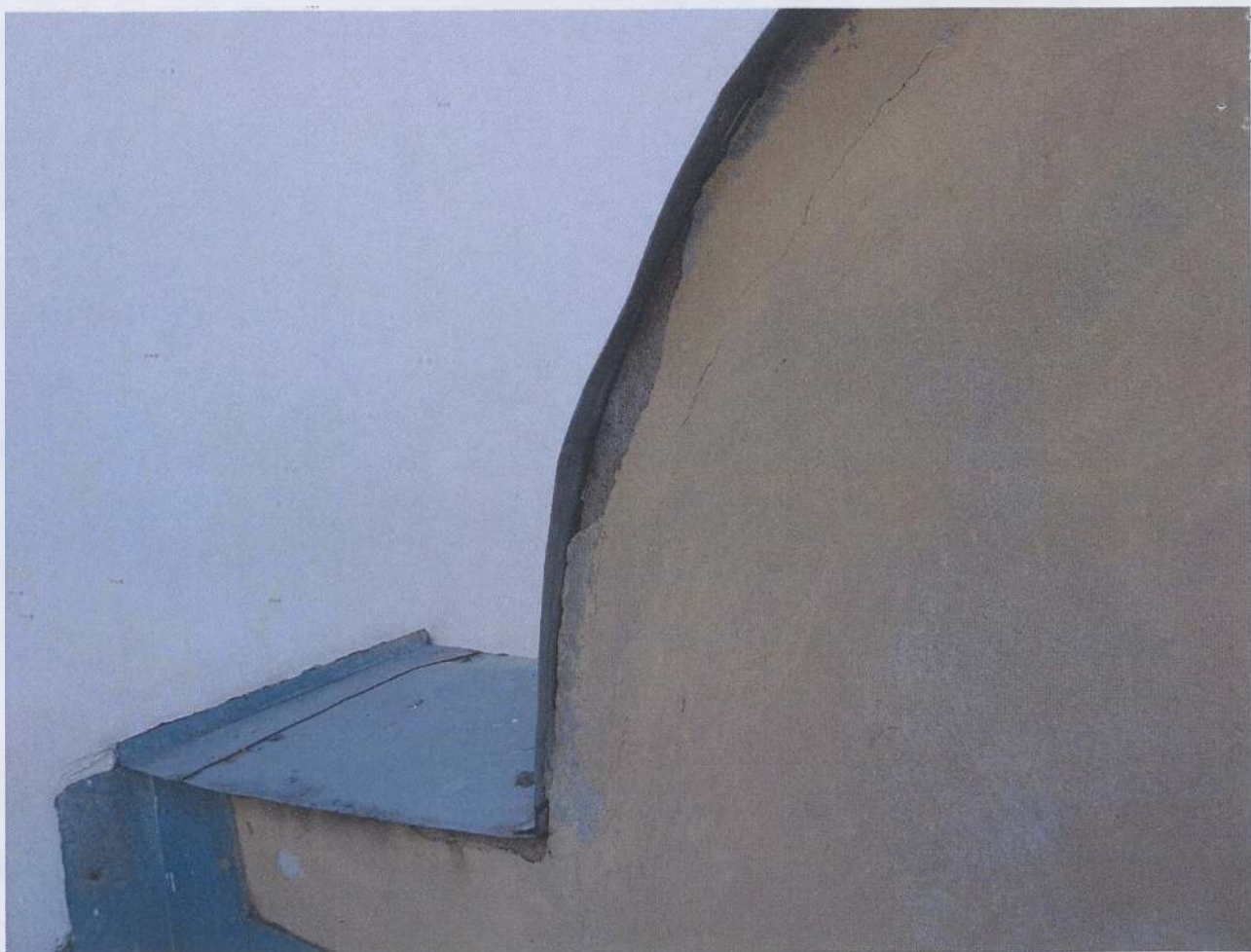
Brak kapinosów w pokryciu attyki umożliwia podciekanie wody
