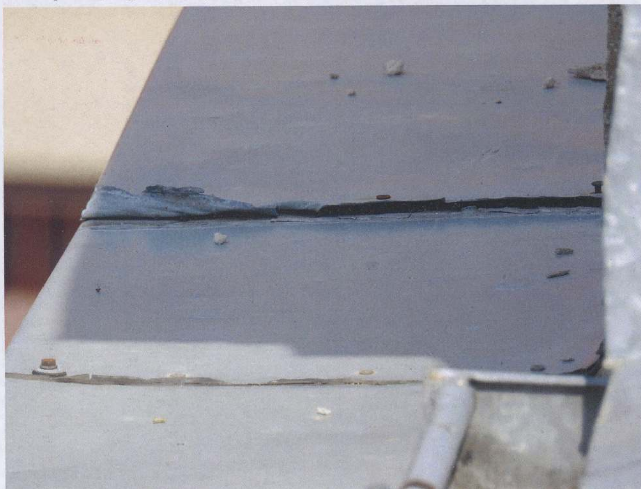
Rozwarstwiona obróbka gzymsu
