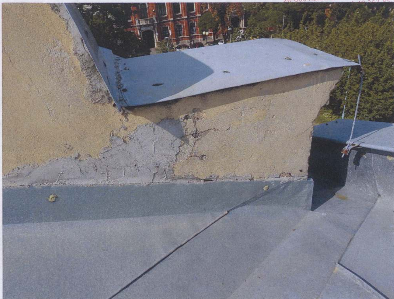
Brak uszczelnień elastycznych połączenia obróbki ze ścianą.
