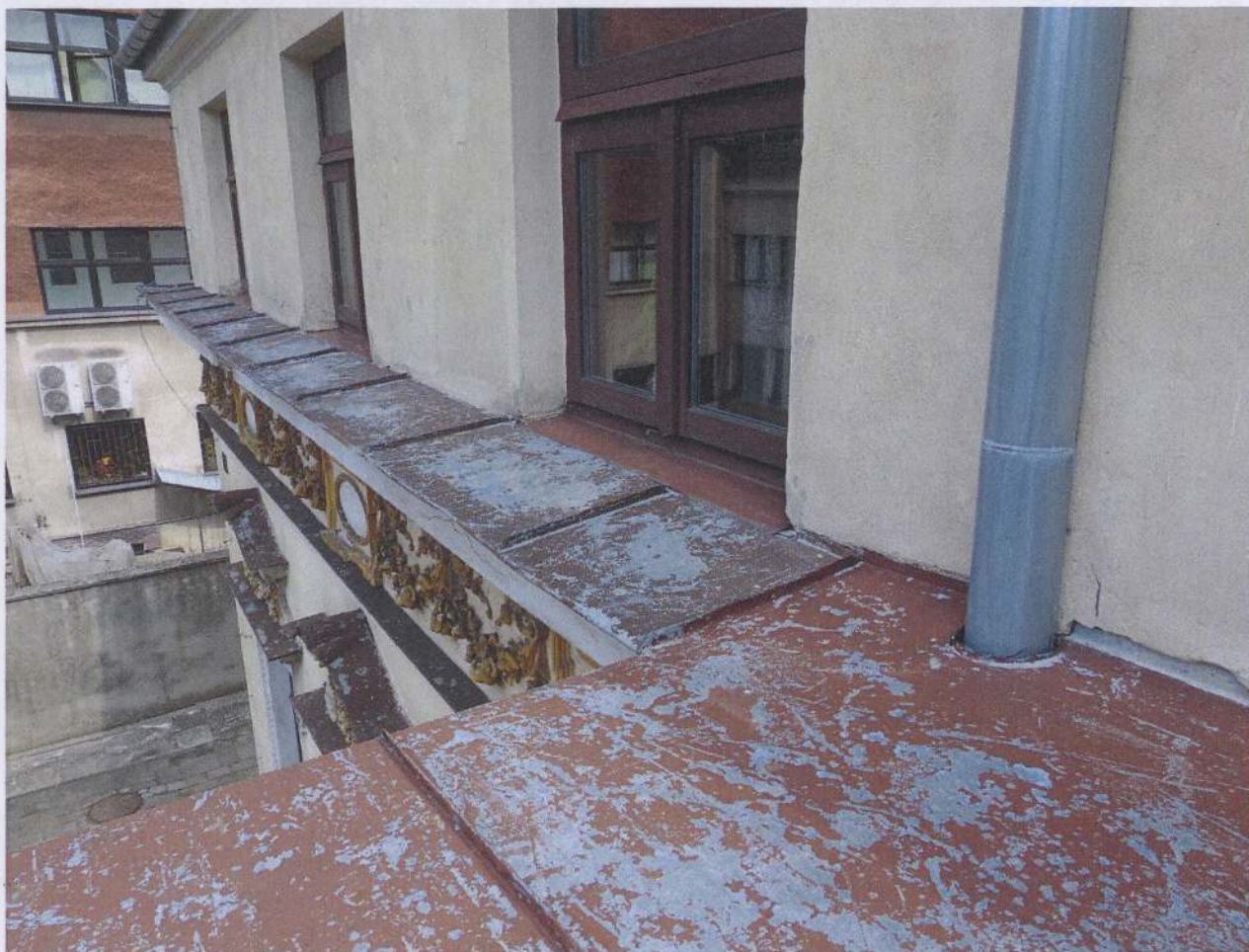
Brak uszczelnienia przejścia rury spustowej.
