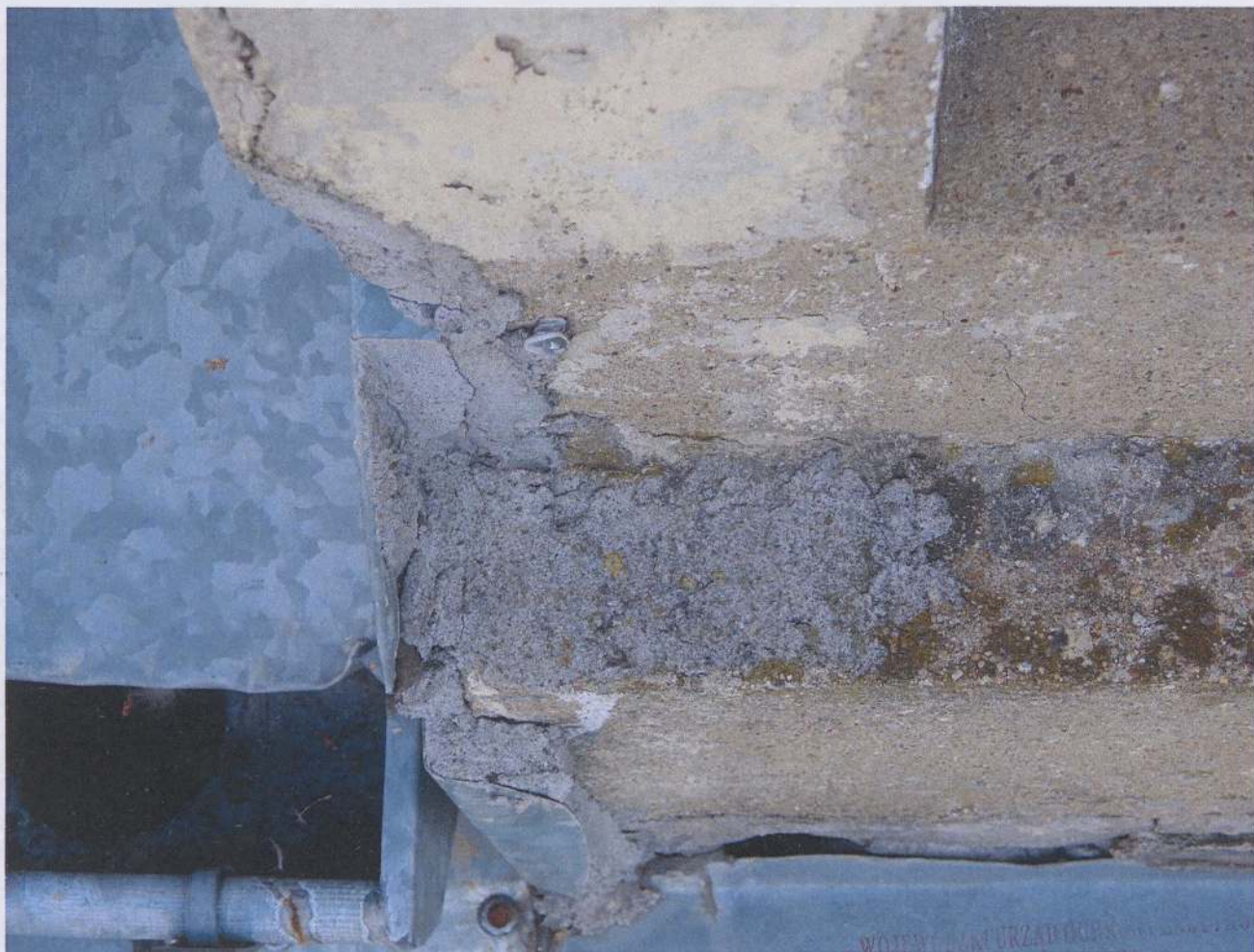
Nieszczelność między obróbką poziomą gzymsu a ścianą attyki umożliwia penetrację dużych ilości wody podczas opadów deszczu.
