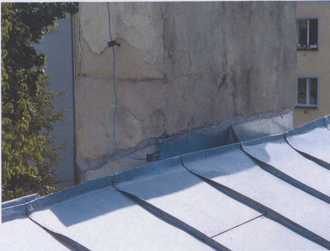
Nieprawidłowa i nieuszczelniona obróbka.
